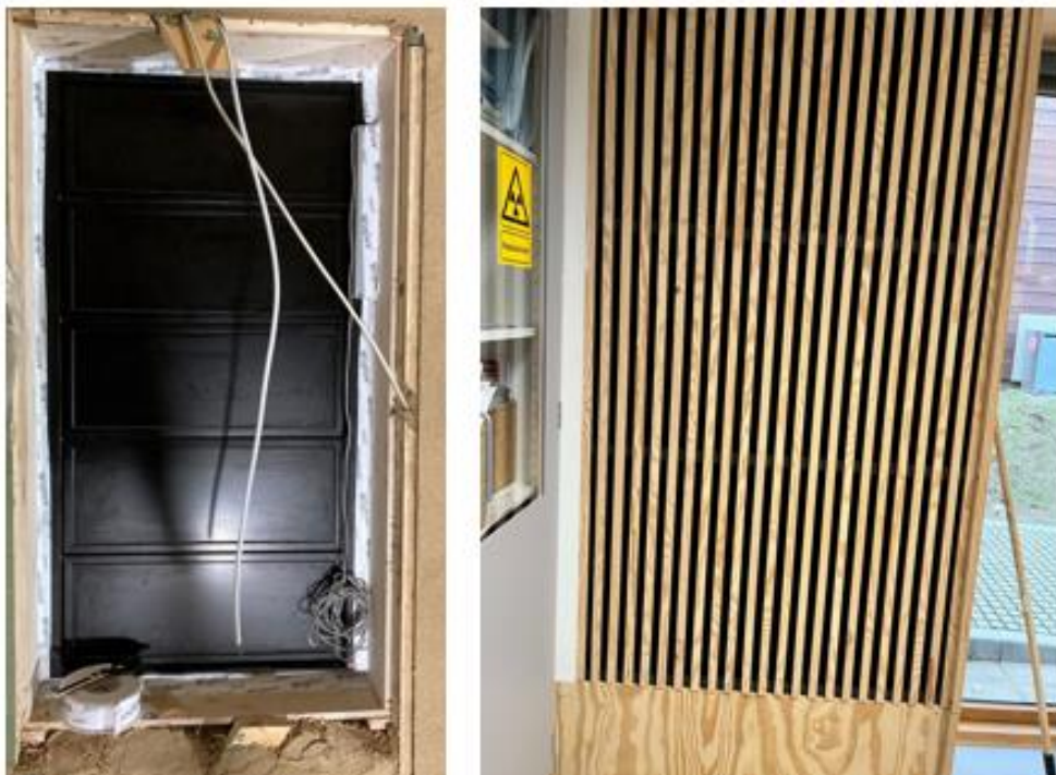
Figur 5.5. Spjældelement etableret på Feldballe Friskole samt lamelfront.
