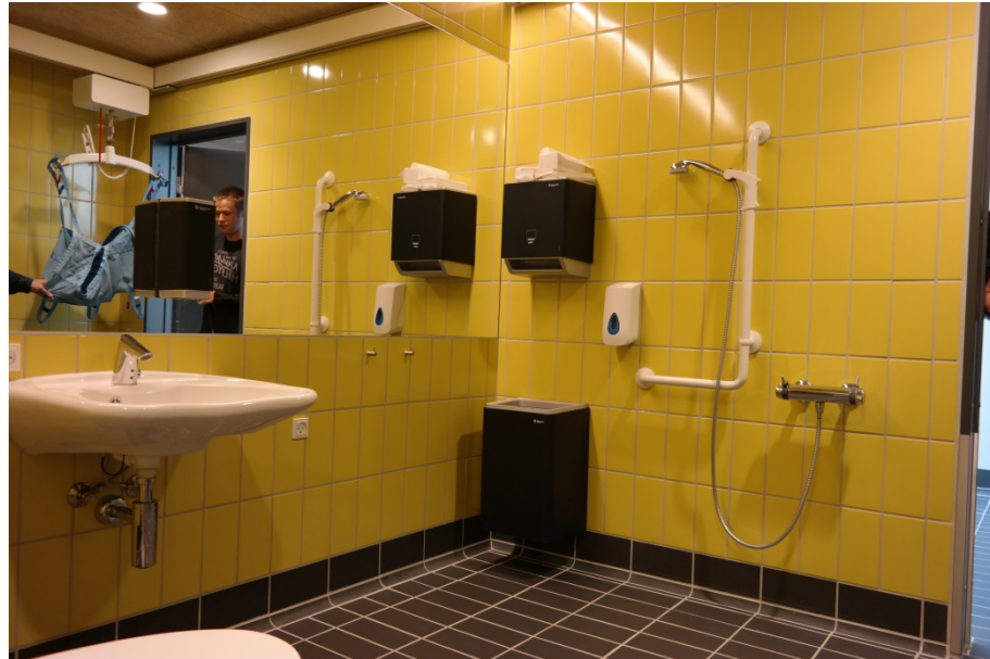
Kabine med loftslift.
