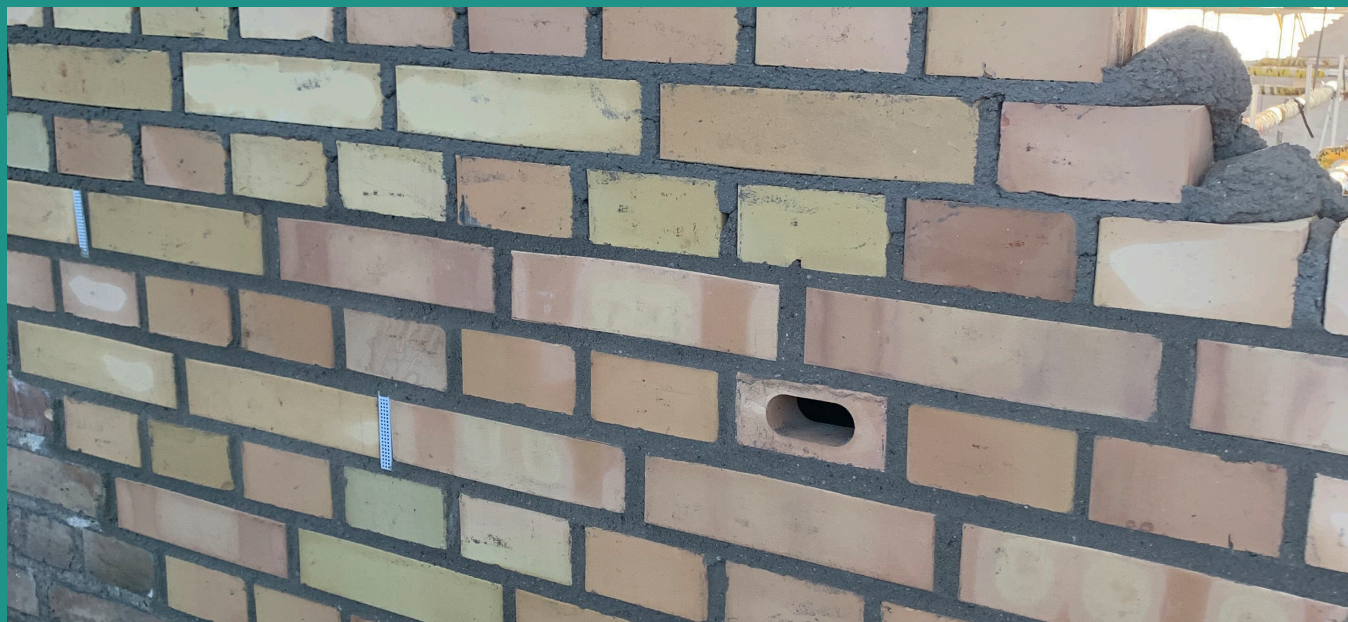
Figur 24 Teglsten designet som redekasse til mursejlere i Dalhusene i Vanløse. (Foto: Niels Christian Nielsen, Arkitektfirma A/S Hune & Elkjær).
