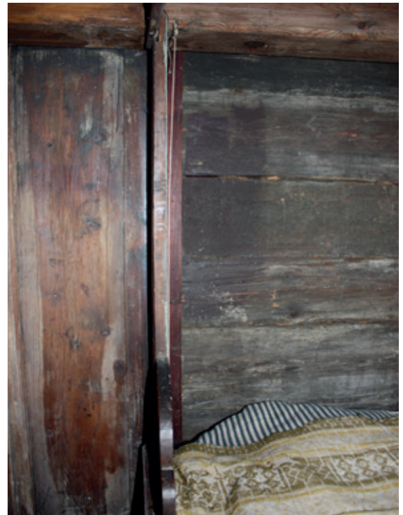
FIG 5: Udsnit af alkove i hus fra Halland, nu Frilandsmuseet, hvor tømmerstokkene er afrettet. Bemærk svindrevnernes udfyldning med uldfibre. © Henriette Ejstrup, 2015
