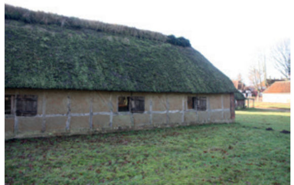
FIG 16: Sulegården på Hjerl Hede ses her med et ældre anlagt stråtag og mønning i strå. Bindingsværket er simpelt med lerpuddede tavler. © Henriette Ejstrup 2015
