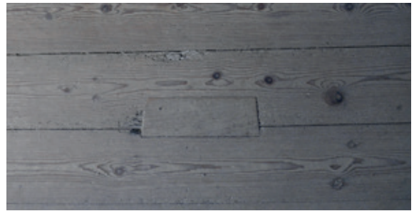
FIG 24: Udlusning i bræddegulv i bygning i Den Fynske Landsby. © Henriette Ejstrup 2024
