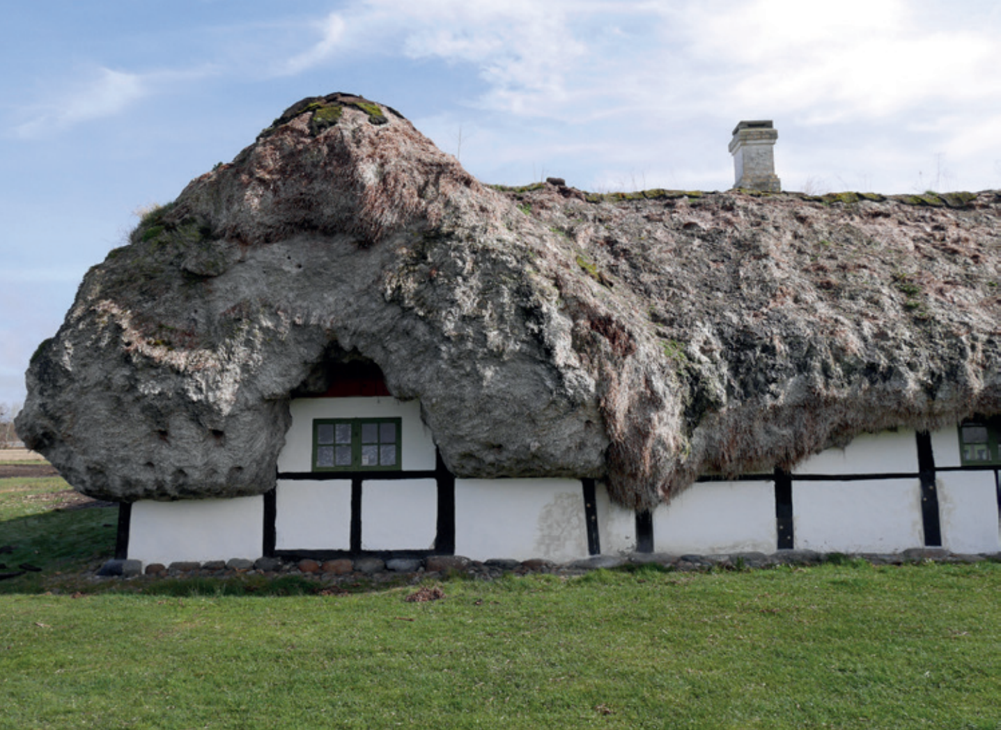
FIG 22: Lynggården på Læsø er opført som en højremskonstruktion. Bindingsværkets tømmer er spinkelt uden overflødig brug af træ, da dette var en mangelvare på øen. Træ var derfor ofte noget man bjærgede fra strandinger. Konstruktionen har ingen gennemgående fodrem hvorfor de fleste stolper hviler direkte af på en linje af syldsten. © Henriette Ejstrup, 2024
