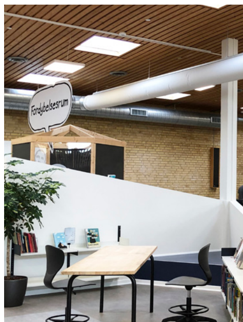
På biblioteket er de nye tekstilkanaler tilkøbt det eksisterende ventilationssystem og ført under loftet. Foto: KE Fibertec
