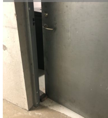
2019: KLODS I DØR TIL AFFALDSRUM
