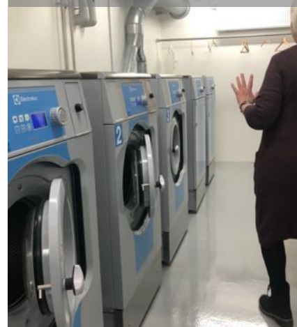
2020: VASKERUM OG RADIATOR
