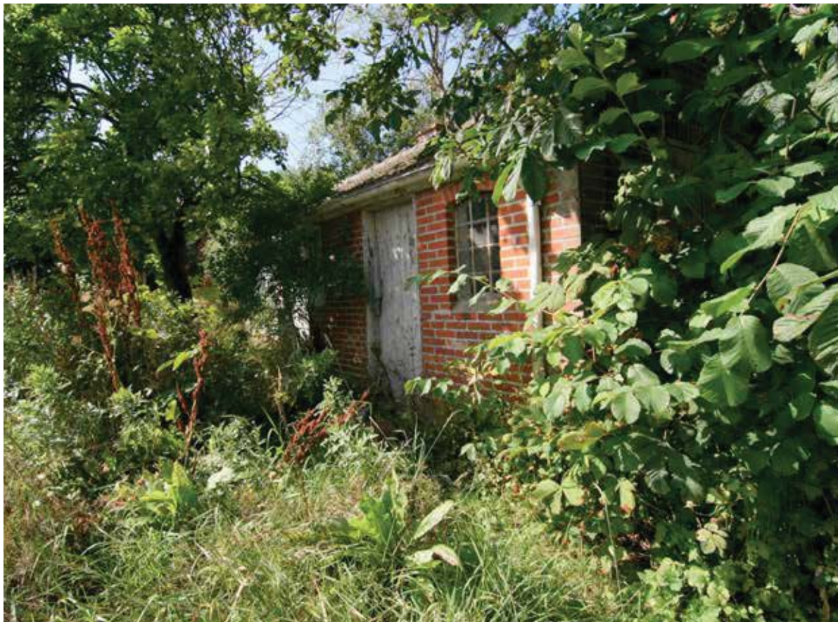
HUSE I FORFALD. Husene bliver revet ned dér, hvor det gør størst forskel for landsbyerne socialt, økonomisk og fysisk.
